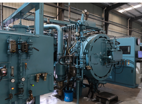
一体分压烧结设备（部分）
